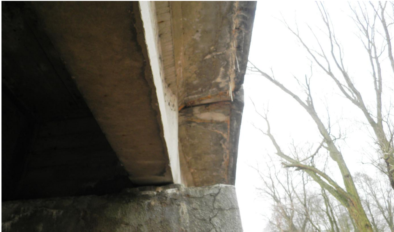
Fot.7 Wykwity i zacieki pod chodnikowa płytą pomostową
