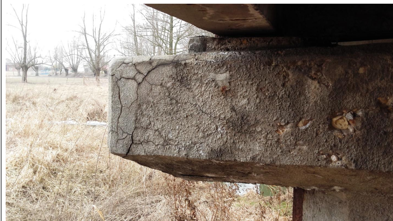
Fot.9 Zakończenia wsporników oczepów filara z wyraźnymi spękaniem otuliny
