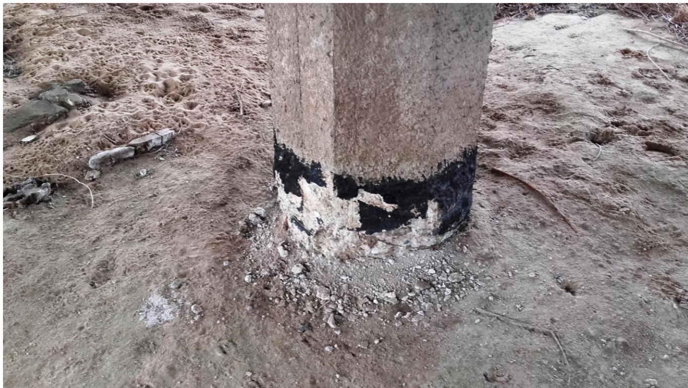
Fot.11 Erozja otuliny słupów filara o przekroju sześciokątnym na poziomie gruntu
