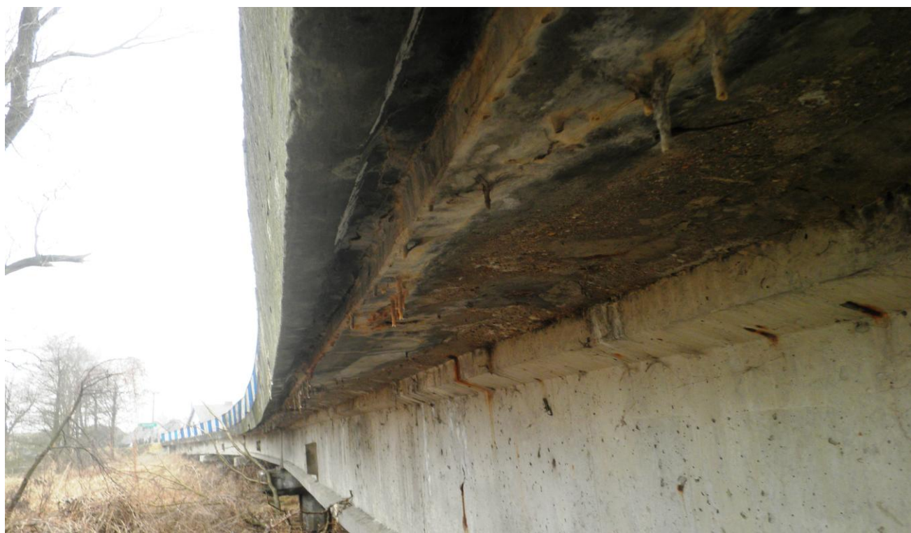
Fot. 8 Nacieki i stalaktyty powstałe w miejscu rys pod uszkodzoną izolacją
