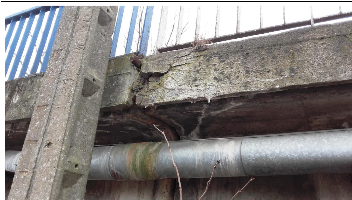
Fot. 10 Nacieki i wykwyty w okolicy dylatacji chodnikowej od strony dolnej wody
